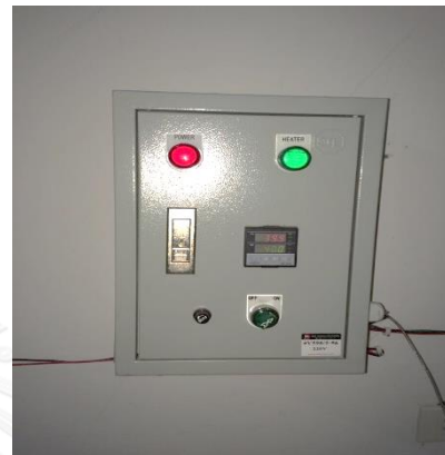
แผงไฟฟ้าควบคุมอุณหภูมิ
