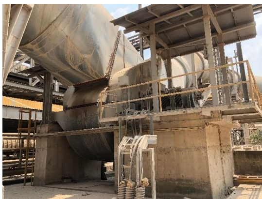
ภาพที่ 4.8 พัดลมหอยโขงขนาดใหญ่ที่เชื่อมต่อกับท่อลมไปยังเครื่องบดวัตถุดิบ
