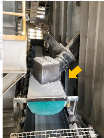
ภาพที่ 4.11 ท่อทรายที่ออกจากเครื่องบดวัตถุดิบลงสู่สายพานลำเลียง
