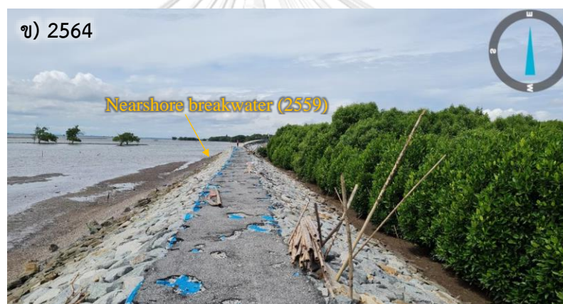
ข) ป่าชายเลนเจริญเติบโตเต็มด้านหลังเขื่อนกันคลื่นที่ถูกสร้างในปี 2557 โดยระดับท้องน้ำ ด้านหลังโครงสร้างสูงกว่าด้านหน้า ประมาณ 1 ม. ใช้เวลา 5 ปี หลังการก่อสร้าง รูป 5-11 การงอกของป่าชายเลนด้านหลังเขื่อนกันคลื่นใกล้ชายฝั่ง บริเวณบ้านคลองหงษ์ทอง (Sta.31+860–Sta.32+220)
