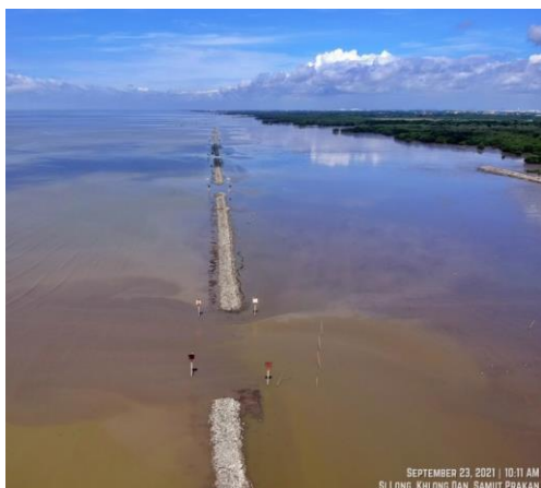
รูป ก-7 เขื่อนกั้นคลื่นจมน้ำ ฝั่งตะวันตกของบ้าน สีลัง
