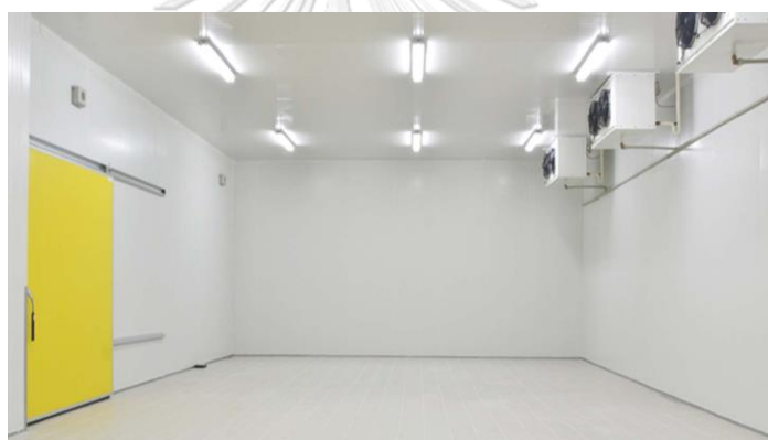
รูปที่ 4.2 ตัวอย่างห้องเย็นสร้างหน้างาน
