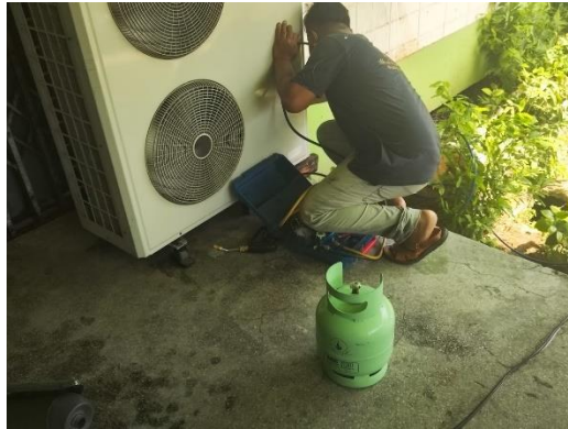
รูปที่ 28 การตรวจสอบการรั่วซึมของน้ำยาแอร์ภายหลังจากล้างเครื่องปรับอากาศ
