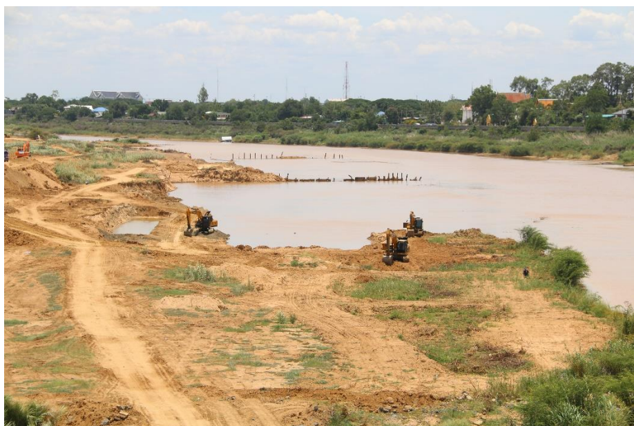
ภาพที่ 5 การขุดลอกทรายในแม่น้ำเจ้าพระยา บริเวณเขตเทศบาลเมืองสิงห์บุรี โดยกรมเจ้าท่า (สำนักข่าวกรมประชาสัมพันธ์, 2563)
