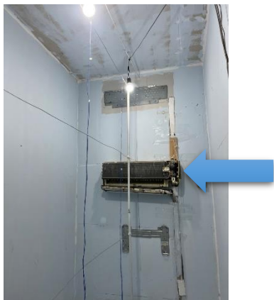
ภาพที่ 33 เครื่องปรับอากาศ ณ ระดับ C (+1.47 ม.) ระดับเหนือลำตัว โดยวัดจากขอบล่างเครื่อง
