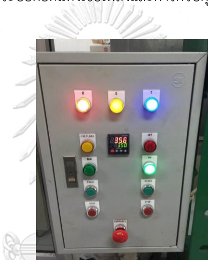
รูปที่ 4.9 ตู้คอนโทรลไฟฟ้าสำหรับตั้งเวลาและอุณหภูมิ
