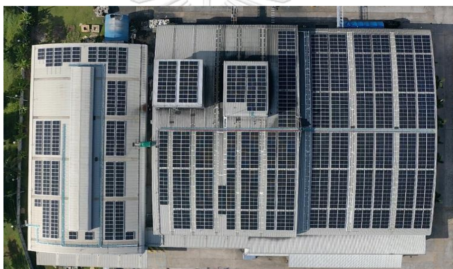
รูปภาพที่ 37 ระบบเซลล์สุริยะที่ติดตั้งบนหลังคาโครงการที่ 2
