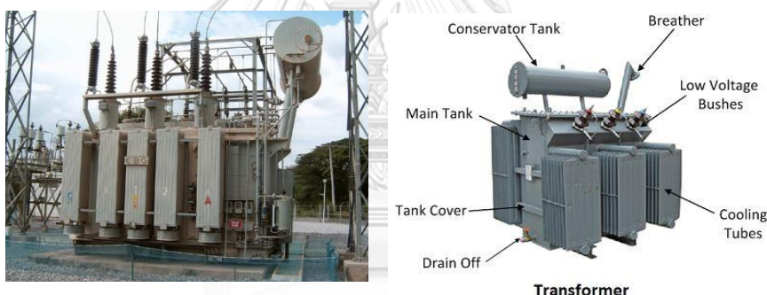
ภาพที่ 3.6 แสดงตัวอย่างหม้อแปลงไฟฟ้า
