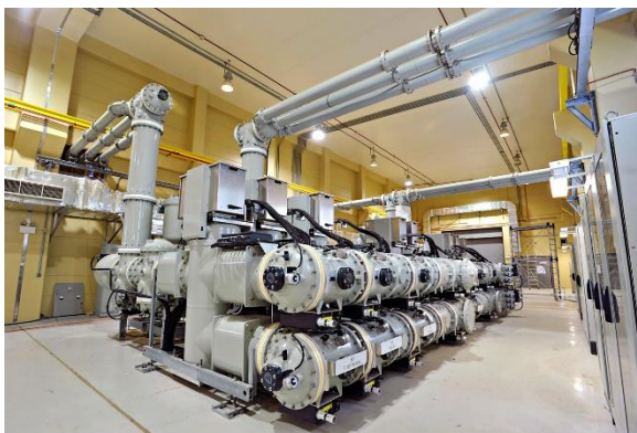
ภาพที่ 3.3 สถานีไฟฟ้าแรงสูงแบบใช้ฉนวนก๊าซ
