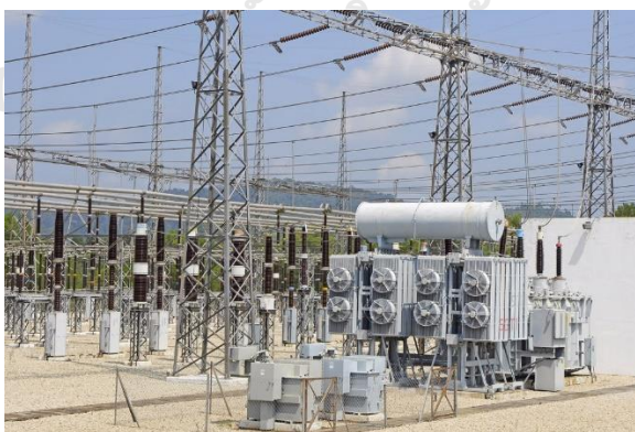
ภาพที่ 3.2 สถานีไฟฟ้าแรงสูงแบบใช้ฉนวนอากาศ
