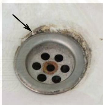
รูปที่ 8 ห้องน้ำตึกฟิสิกส์ จุฬาลงกรณ์มหาวิทยาลัย กรุงเทพมหานคร สถานที่คัดแยกเชื้อราไอโซเลต PH1 บริเวณที่เก็บตัวอย่างคือ ช่องระบายน้ำบนอ่างล้างมือ (ลูกศรชี้)
