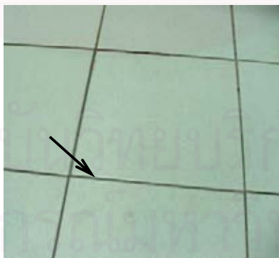
รูปที่ 6 ห้องน้ำที่พักอาศัย เขตบางมด กรุงเทพมหานคร สถานที่คัดแยกเชื้อราไอโซเลต BM1 บริเวณที่เก็บตัวอย่างคือขอบกระเบื้องปูพื้นห้องน้ำ (ลูกศรชี้)
