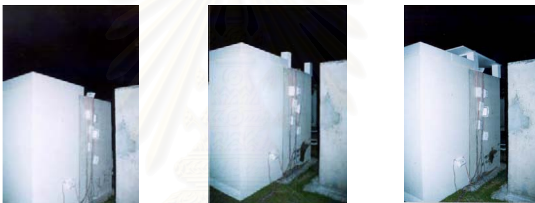
รูปที่ 3.14 แสดงระบบ เปิด - ปิด - บังแดดบ่อน้ำ ชุดที่ 4 - บ่อกลาง
