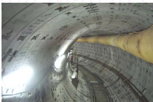
รูปที่ 3.14 ดาตผนังอุโมงค์ที่ประกอบครบเป็นวง (สำนักการระบายน้ำ, 2548)
