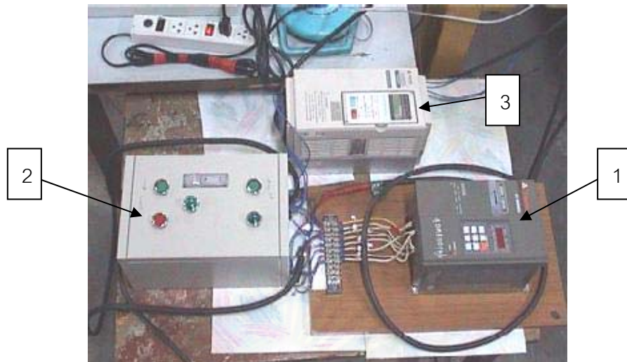
รูปที่ ง.2 กล่องควบคุม (Control Box) และ อินเวอร์เตอร์ ประกอบด้วย 1) อินเวอร์เตอร์ควบคุมความเร็วกระบะ 2) กล่องควบคุมการเคลื่อนที่กระบะ 3) อินเวอร์เตอร์ควบคุมความเร็วเพลลาใบมีด
