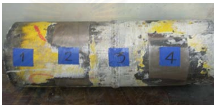
รูปที่ 3.5 แสดงตำแหน่งในการวัดท่อเหล็กกล้าที่มีรอยเชื่อม ผ่านการปาดผิวให้มีความหนาต่างกัน (ตำแหน่งที่ 1 หนา 14.0 มม. ตำแหน่งที่ 2 หนา 13.6 มม. ตำแหน่งที่ 3 เป็นรอยเชื่อม และตำแหน่งที่ 4 ความหนา 13.8 มม.)
