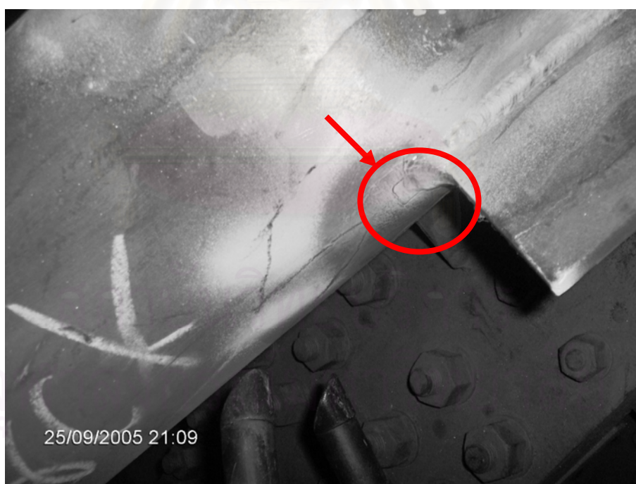
รูปที่ 1.2 การตรวจสอบสภาพหาความเสียหายชิ้นส่วน 1 BUE-2 Joint 2 ของสะพานพระรามเก้า
