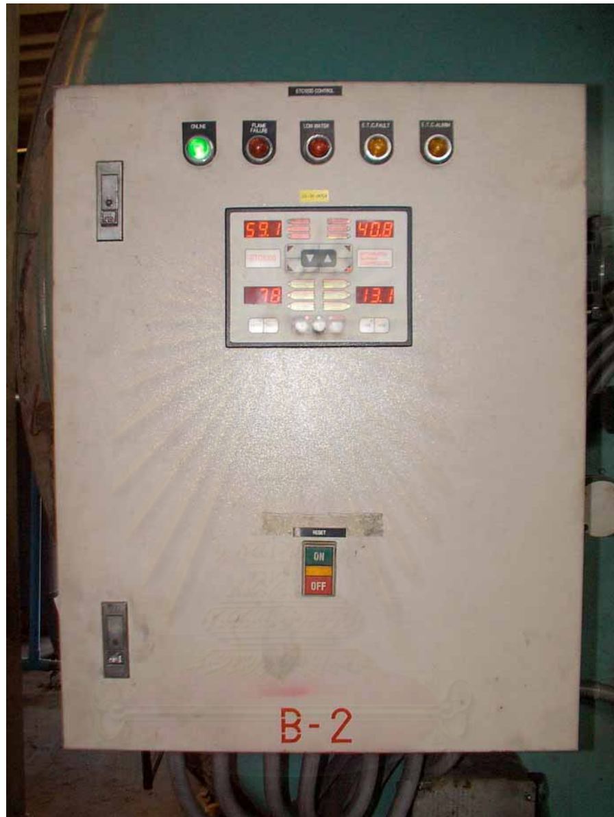
รูปที่ ก.4 ศูนย์ควบคุมการเผาไหม้แบบอัตโนมัติ สถานบริการ จุฬาลงกรณ์มหาวิทยาลัย
