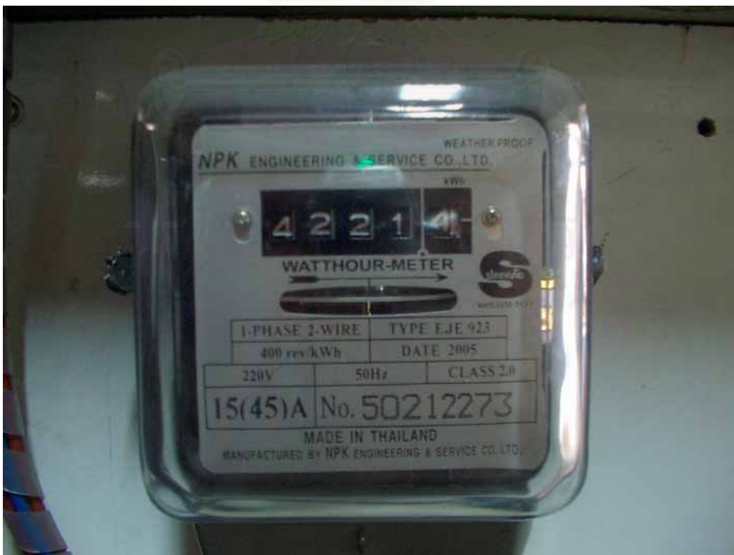
รูปที่ ก.6 มิเตอร์วัดหน่วยการใช้ไฟฟ้า
