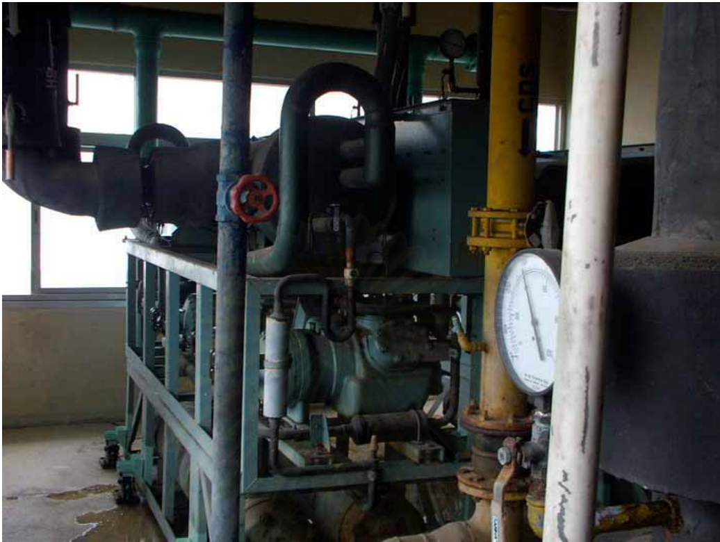
รูปที่ ก.5 เครื่องทำน้ำเย็น
