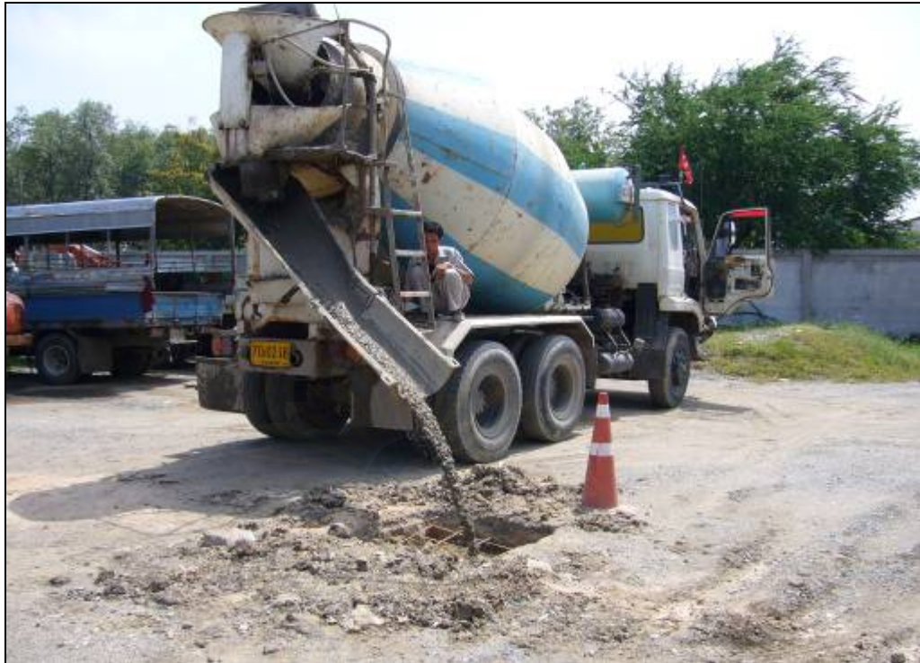
รูปที่ 3.28 เทคอนกรีตลงในแบบดินความกว้าง 1 เมตร ยาว 1 เมตร หนา 0.20 เมตร
