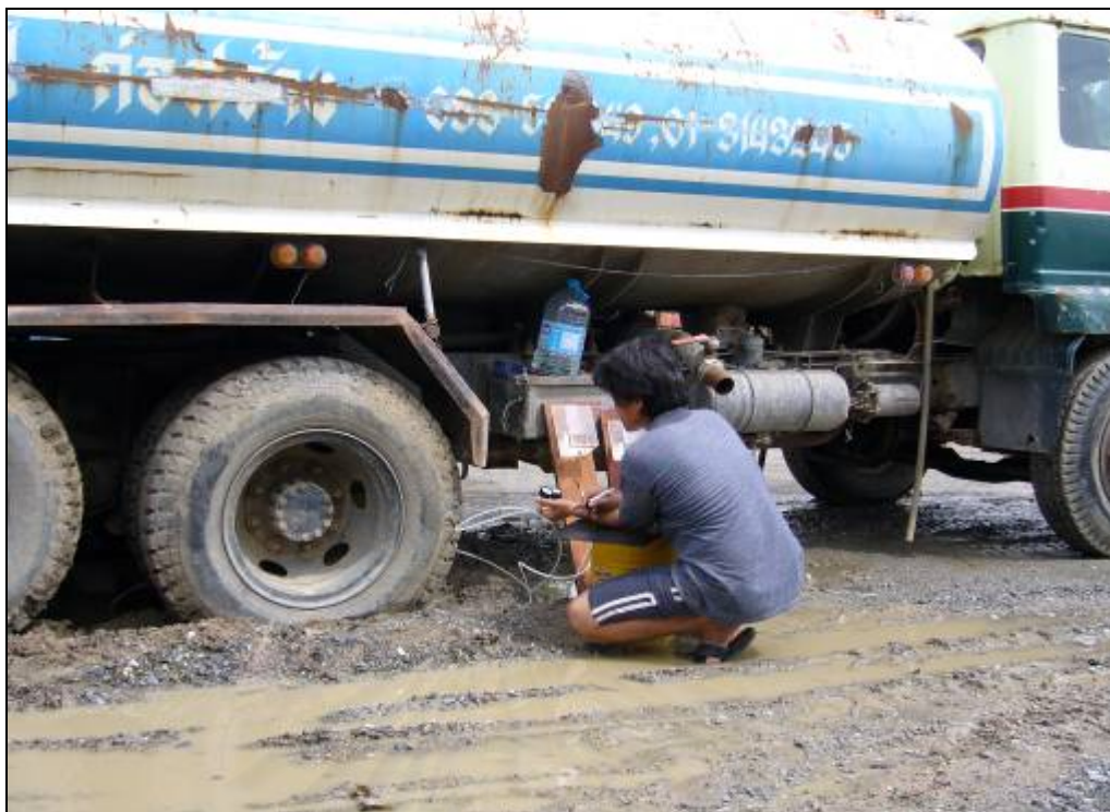
รูปที่ 3.36 รถบรรทุกน้ำบรรจุน้ำเต็ม เพื่อ ใช้เพิ่มน้ำหนักบรรทุกให้กับเสาเข็ม
