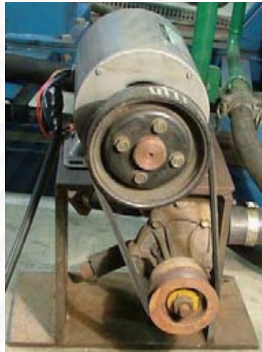
รูปที่ 4-10 แสดงปั๊มน้ำหล่อเย็น
