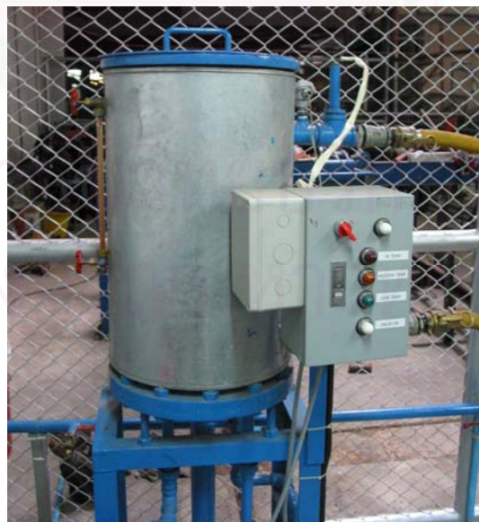
รูปที่ 4-11 แสดงถังพักน้ำหล่อเย็น
