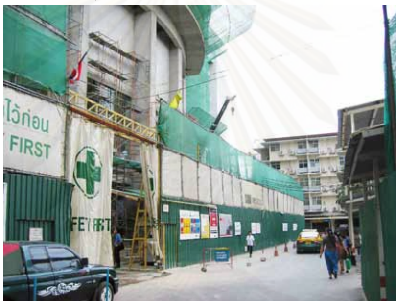
รูปที่ 4.5.4 ภาพการปิดกั้นพื้นที่ก่อสร้าง
