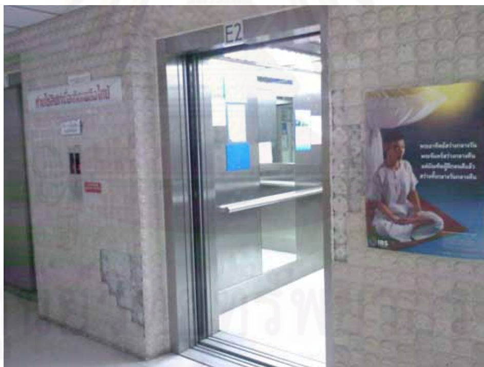
รูปที่ 4.3.4 ภาพการหลุดร่วงของกระเบื้องติดผนัง ในอาคารรัชมงคล (เจ้าหน้าที่อ้างว่าเป็นเพราะโครงการก่อสร้างแต่ไม่สามารถพิสูจน์ได้)
