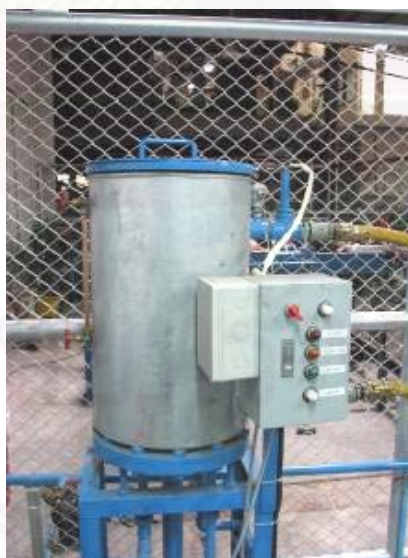
รูปที่ 6-24 Cooling Water Tank
