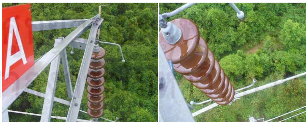
รูปที่ 2.12 อุปกรณ์อาร์คชิ่งฮอร์นติดตั้งกับพวงลูกถ้วยแขวน
