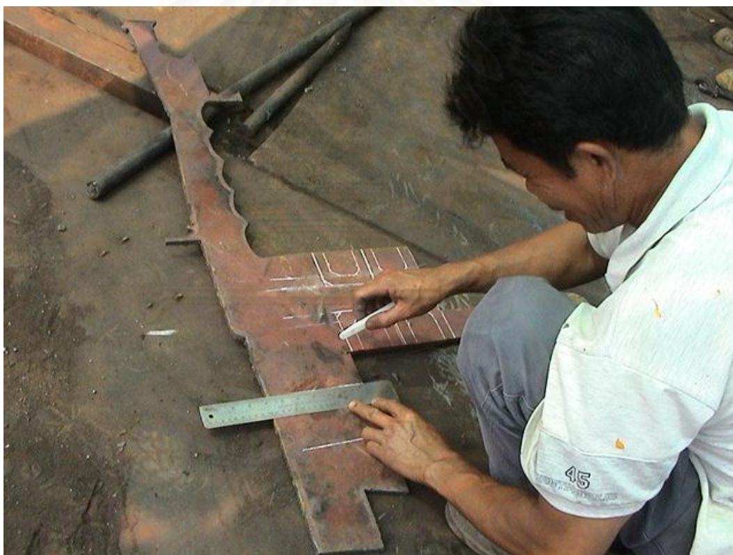
แผนภาพที่ 4.12 ภาพแสดงการร่างแบบตัดวัสดุดิบ
