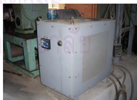
ฉ) หม้อแปลงควบคุม
