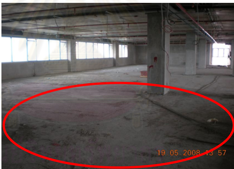
รูปที่ 5.3 บริเวณที่เตรียมปูกระเบื้องโดยไม่มีการการจัดการที่ดีเป็นสาเหตุทำให้เกิดฝุ่นละออง
