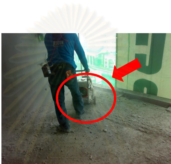
รูปที่ 4.17 ฝุ่นที่เกิดจากการขัดพื้นในหน่วยงานก่อสร้างโครงการที่ 3
