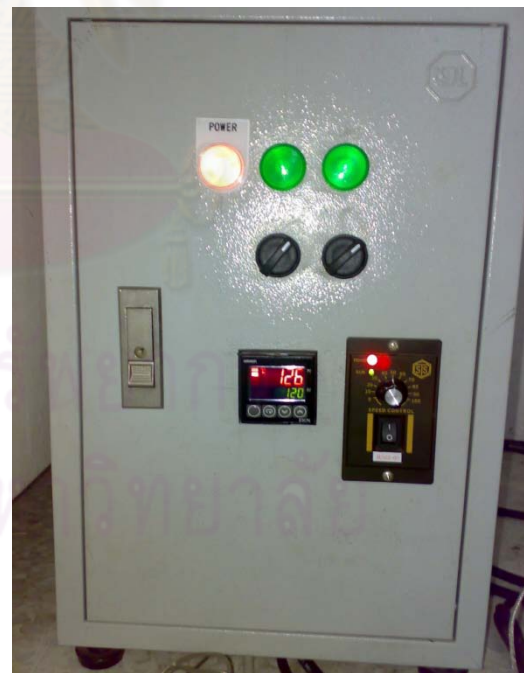
ตู้ควบคุมอุณหภูมิ
