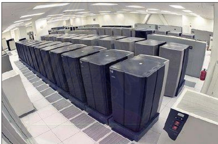
รูปที่ 2.2 ศูนย์คอมพิวเตอร์
