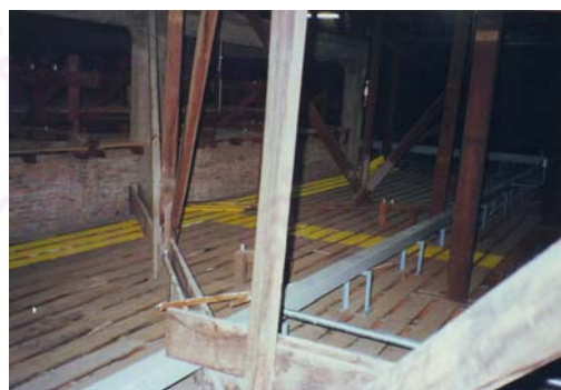
ภาพที่ 4-77 ระบบไฟฟ้าในห้องใต้หลังคา
