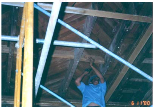
ภาพที่ 4-70 การเสริมตงไม้เพิ่มเติมกับโครงสร้างพื้นไม้ห้องท้องพระโรงชั้น 2 : 2543
