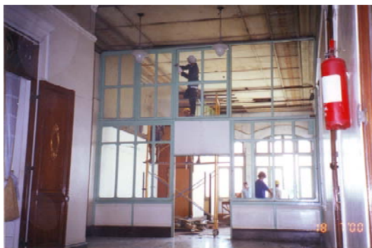
ภาพที่ 4-58 การรื้อถอนผนังส่วนต่อเติม : 2542 ที่มา : บริษัท เดียบอร์น สตรีท ดีไซน์ อินเตอร์เนชันแนล จำกัด
