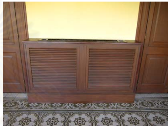
ภาพที่ 2-11 ตู้เครื่องปรับอากาศภายในอาคาร ที่มา : ผู้วิจัย
