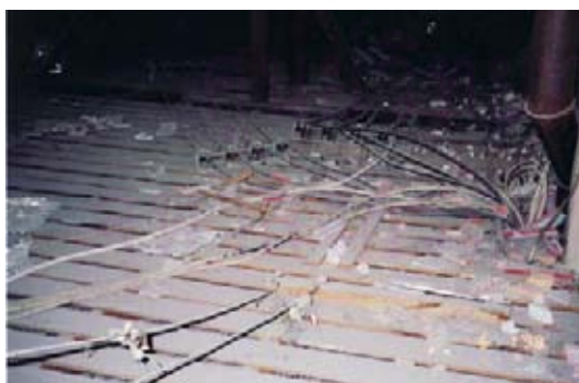
ภาพที่ 4-76 ระบบไฟฟ้าในห้องใต้หลังคา
