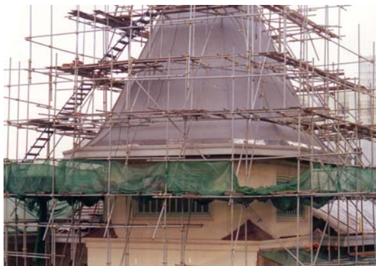
ภาพที่ 4-29 หลังคาหอคอยทาสีกันซึมชนิดพิเศษ : 2542 ที่มา : บริษัท เดียบอร์น สตรีท ดีไซน์ อินเตอร์เนชั่นแนล จำกัด
