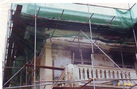
ภาพที่ 4-61 การรื้อถอนผนังส่วนต่อเติม : 2542 ที่มา : บริษัท เดียบอร์น สตรีท ดีไซน์ อินเตอร์เนชันแนล จำกัด
