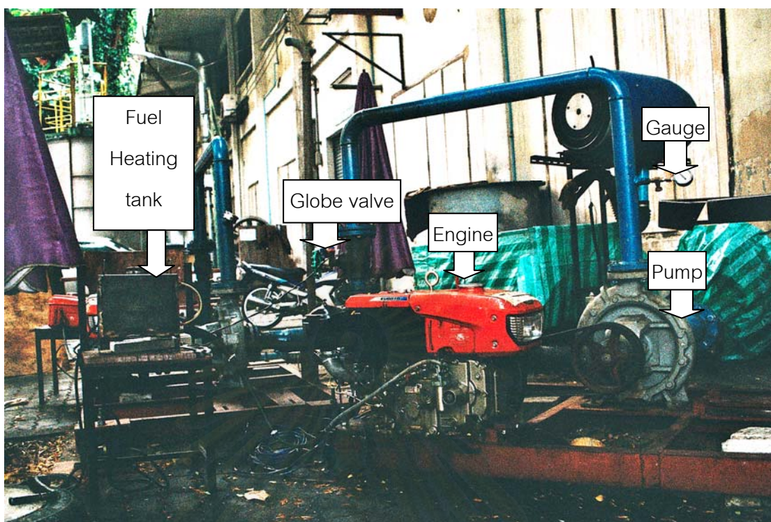
รูปที่ 3-22 แสดงเครื่องยนต์ติดตั้งร่วมกับระบบปั้มน้ำในการทดสอบความทนทาน
