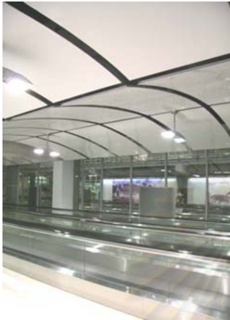
โคมเดิม แต่เปลี่ยนทิศทางให้คว่ำลง หลอด เมทัลฮาไลด์ 2x150 watt
