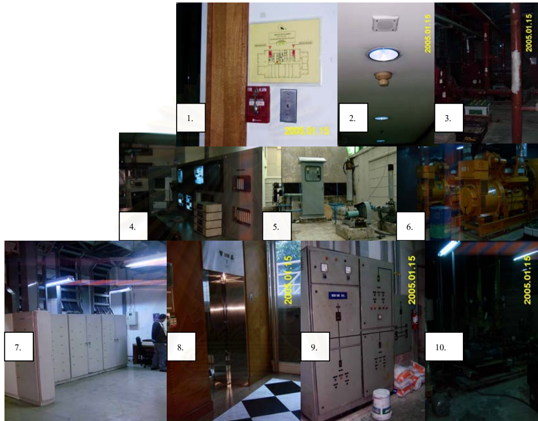
ภาพที่ 3.6 แสดงภาพถ่ายระบบสาธารณูปโภคภายในอาคาร
