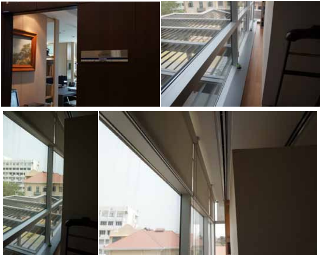
ภาพที่ 4-49 แสดงภาพถ่ายภายใน ผนังบริเวณที่รั้วซีม
