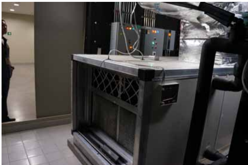
ภาพที่ 4-28 แสดง AHU เมื่อติดตั้งแล้วเสร็จ โครงการที่ 11
