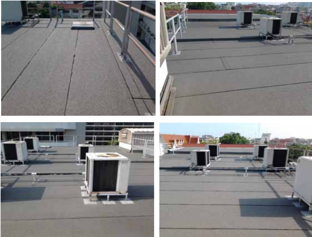
ภาพที่ 4-29 แสดง ภาพงานปรับปรุงระบบกันซึมหลังคา เมื่อติดตั้งแล้วเสร็จ โครงการที่ 12
