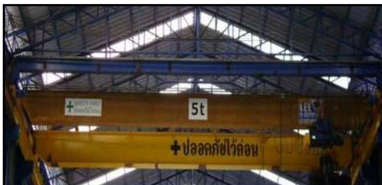
ภาพที่ 2.7 Overhead Crane ขนาด 5 ตัน
