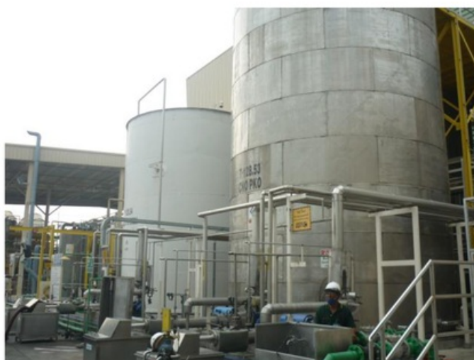
รูปที่ 1-3: พื้นที่จัดเก็บน้ำมัน, โซดาไฟ, เกลือ และกรดเกลือ สำหรับใช้ใน Making Process
