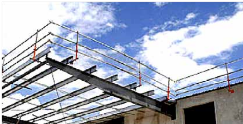
ภาพที่ 4.2 รวากันตงแบบราวบนและราวกลางสองแถว
