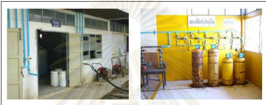
รูปที่ 4.18 อาคารจ่ายสารเคมีของเทศบาลนครนครปฐม
