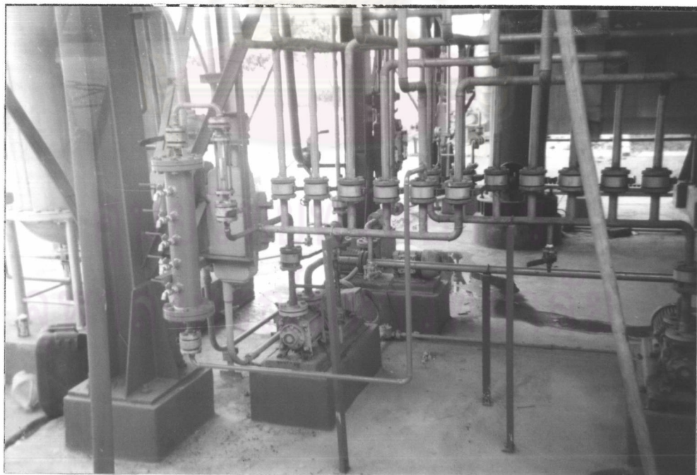
รูปที่ 3.5 แสดงการติดตั้งเครื่องมือเพื่อทำการทดลอง ตามอุปกรณ์การทดลองในข้อ 3.2.1.2 (รูปถ่ายแสดงการลำเลียงอะซิโตนผ่านหลอดขับ เข้าและออก)
