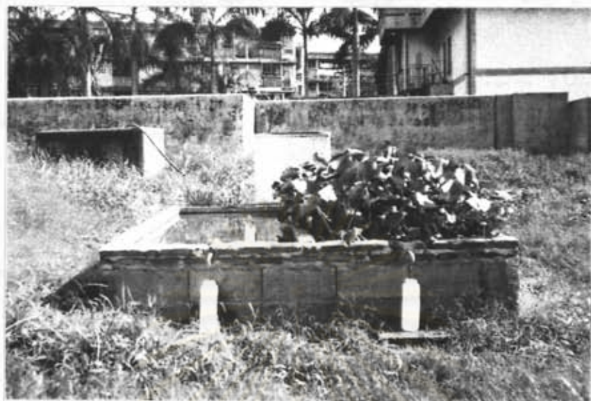
รูปที่ ก-7 แสดงบ่อควบคุมและบ่อฝักตะกอน
