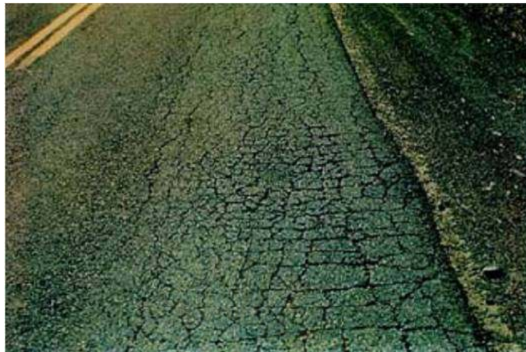
รูปที่ 2.3 รอยแตกร้าวเนื่องจากความล้า (Fatigue cracking) (เอกสารประกอบรายวิชา Pavement Design)
