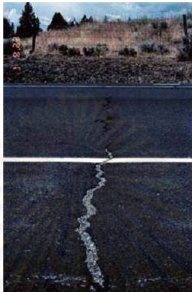
รูปที่ 2.5 รอยแตกกว้างเนื่องจากอุณหภูมิ (Thermal cracking) (เอกสารประกอบรายวิชา Pavement Design)
