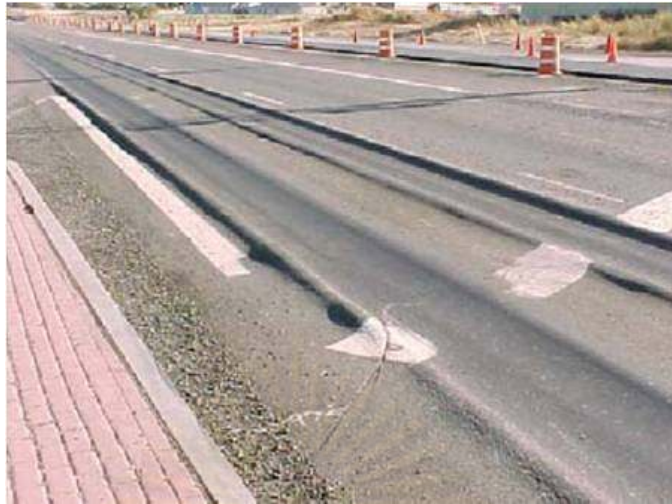
รูปที่ 2.6 รอยร่องล้อเนื่องจากส่วนผสม (เอกสารประกอบรายวิชา Pavement Design)
