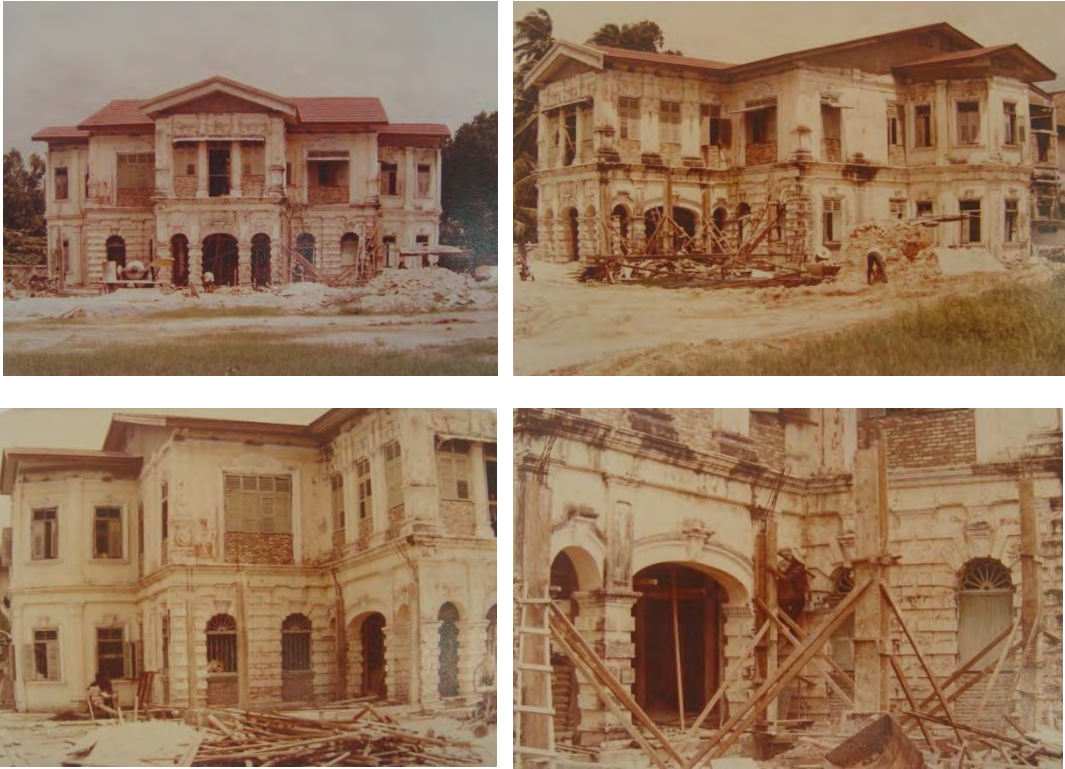
ภาพที่ 5.40 ภาพขณะการต่อเติมบริเวณต่อเติมส่วนด้านหน้าของชั้นล่าง บ้านพระอร่ามสาครเขตร ส่วนที่สามเป็นโรงพยาบาลศิริโรจน์ ที่มา : คุณผ่องศรี แสงสุคนธ์ เป็นบานกระจกแบบเลื่อนได้ มีวงกบอลูมิเนียมสีเงิน
