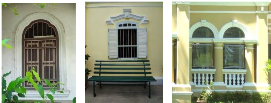
ภาพที่ 4.41 หน้าต่างชั้นล่างของบ้านคุณเต็งก๊ก แซ่หงอ บ้านพระพิไลยสรรพกิจ และบ้านพระพิทักษ์ชินประชา (จากซ้ายไปขวาตามลำดับ) ที่มา : การสำรวจของผู้วิจัย, 9 ตุลาคม 2555
