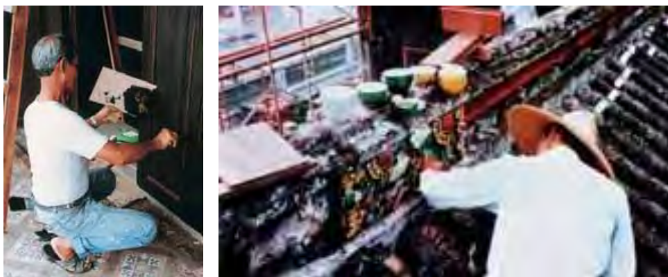
ภาพที่ 6.1 ภาพการซ่อมแซมของช่างท้องถิ่นในป็นัง บ้าน เฉิง ฟัด เจ้อ แมนชั่น
