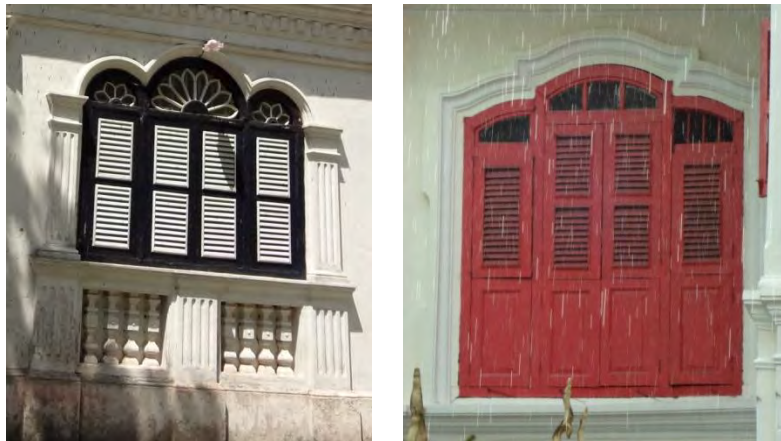
ภาพที่ 4.93 หน้าต่าง ตัวบาน 3 ช่อง บ้านชินประชา และโรงเรียนอนุบาลกนกขวัญ ที่มา : การสำรวจของผู้วิจัย, 9 ตุลาคม 2555
