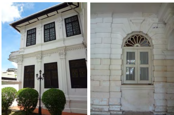
ภาพที่ 4.144 การใช้เสาอิงและผนังเซาะร่องของอาคาร
