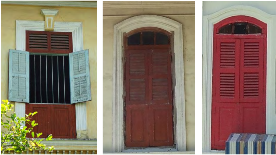
ภาพที่ 4.89 หน้าต่าง ตัวบาน 3 ช่อง บ้านคุณเต็งก๊ก แซ่หงอ บ้านคุณเฉลิม ทองตัน โรงเรียนอนุบาลกนกขวัญ (จากซ้ายไปขวาตามลำดับ) ที่มา : การสำรวจของผู้วิจัย, 9 ตุลาคม 2555
