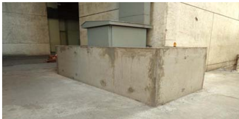
รูปที่ 3.32 จุดที่ 5 บริเวณตู้ไฟฟ้า
