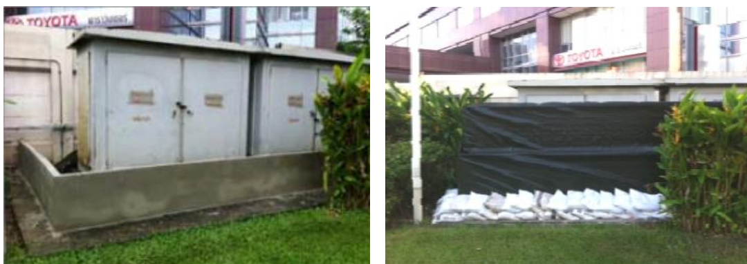
รูปที่ 3.42 จุดที่ 1 ตู้ไฟฟ้าแรงสูงหน้าโครงการ
