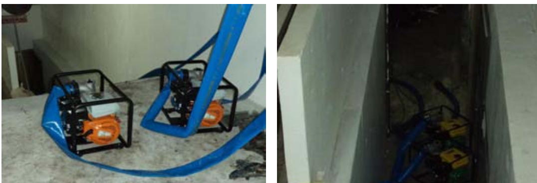
รูปที่ 3.27 การวางเครื่องสูบน้ำหลังแนวกันน้ำ
