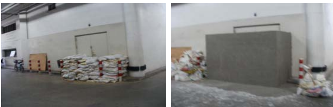
รูปที่ 3.18 จุดที่ 9 ประตูห้องไฟฟ้า (RMU)
