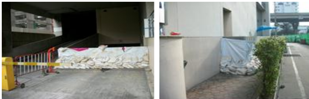
รูปที่ 3.24 ด้านข้างอาคารทิศใต้ บริเวณทางขึ้นจากชั้นใต้ดิน ใช้กระสอบทรายและแผงเหล็ก
