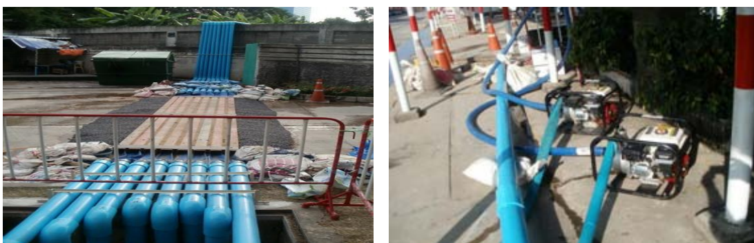
รูปที่ 3.2 เครื่องสูบน้ำเคลื่อนที่ และเครื่องสูบน้ำเสริมจากบ่อพักน้ำ
