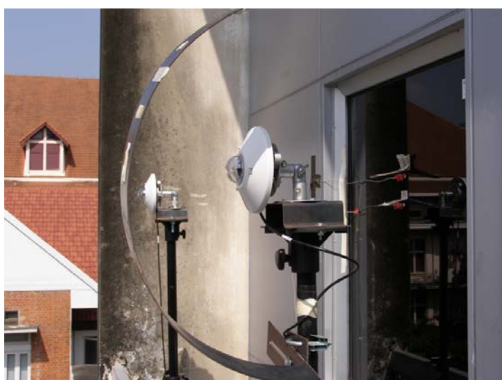
รูปที่ 4.3 การติดตั้งเครื่องวัดรังสีแสงอาทิตย์พร้อมกับอุปกรณ์บังเงาที่ติดตั้งภายนอกอาคาร
