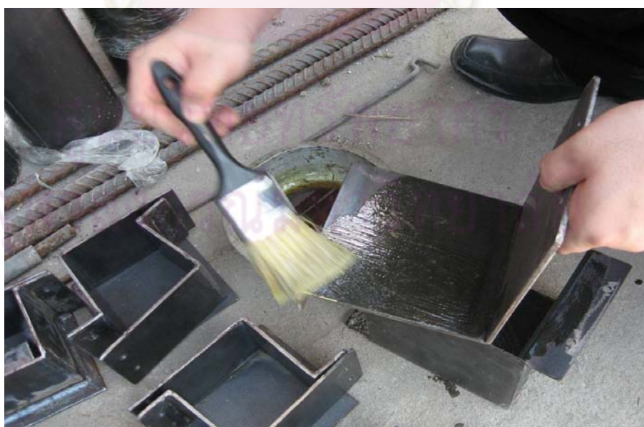
รูปที่ 3.16 การทาน้ำมันพืชเคลือบไว้ที่ผิวภายในแบบหล่อคอนกรีต
