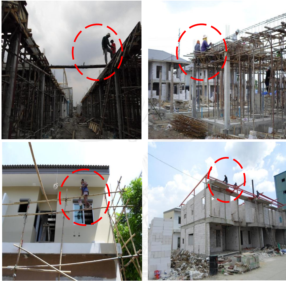
ภาพที่ 4.1 การปฏิบัติงานโดยขาดอุปกรณ์ป้องกันภัยส่วนบุคคล
