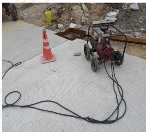
ภาพที่ 1.1 อุปกรณ์ไฟฟ้าที่ไม่เรียบร้อย
