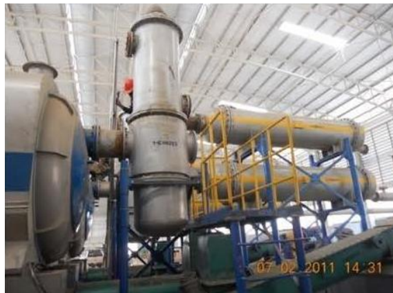
รูปที่ 2.30 เครื่องควบแน่น บจก. ทีพีไอโพลีน
