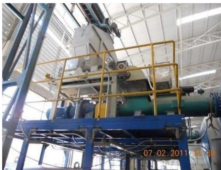
รูปที่ 2.28 เครื่องป้อนขยะ บจก. ทีพีไอโพลีน
