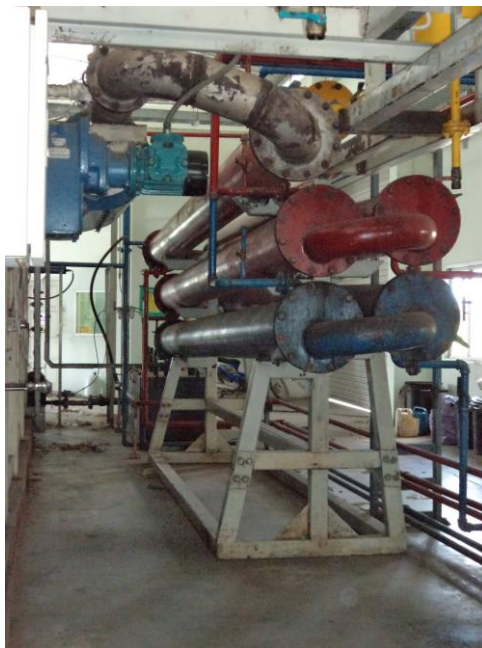
รูปที่ 2.44 เครื่องควบแน่น บจก. ซิงเกิลพอยท์
