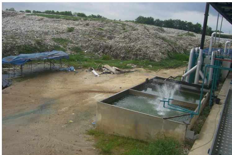
รูปที่ 2.40 ระบบหล่อเย็นแลกเปลี่ยนความร้อนของอุปกรณ์ควบแน่นไอน้ำมัน บจก. เมืองสะอาด
