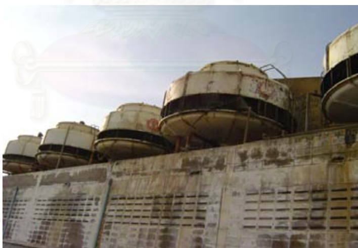
รูปที่ 2.5หอทำความเย็น
