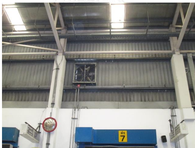
รูปที่ 3.13 พัดลมที่ติดตั้งภายในคลังสินค้า
