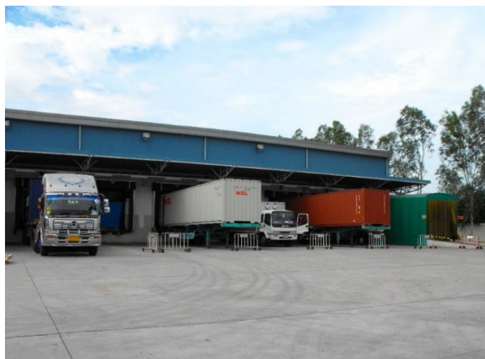
รูปที่ 3.14 หลังคายื่นออกมาเพื่อป้องกันความร้อนไม่ให้กระทบต่อ ตู้คอนเทนเนอร์โดยตรง
