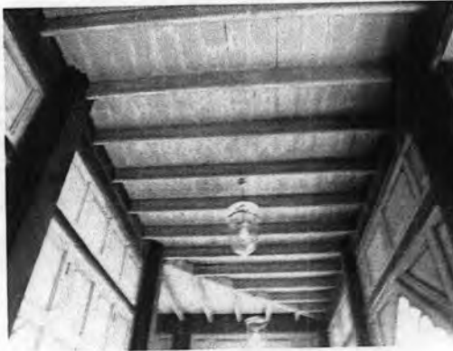
ภาพที่ 3.2-19 ลักษณะโครงสร้างพื้นชั้นที่ 2 บริเวณระเบียงทางเดิน
