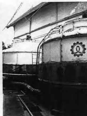
ภาพที่ 3.5.21 ตำแหน่งของหอระบายความร้อนด้านหลังอาคาร
