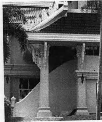
ภาพที่ 3.3-14 ลักษณะของเสาและค้ำยัน บริเวณมุขด้านข้างอาคาร
