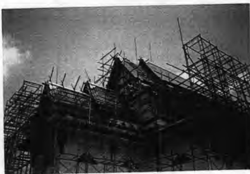
ภาพที่ 3.1-16 ภาพรวมตอนซ่อมโครงสร้างหลังคา แสดงถึงตำแหน่งของแปต่างๆ ก่อนประดับด้วยเครื่องล้าของ
