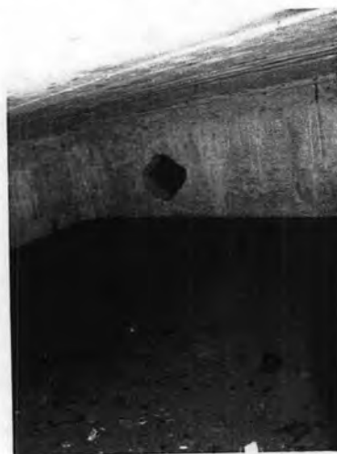
ภาพที่ 3.1-30 บ่อที่เก็บน้ำใต้ดิน บริเวณใต้ถุนอาคาร
