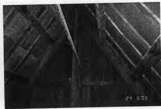
ภาพที่ 3.1-17 ลักษณะโครงสร้างภายในหลังคามุขด้านหน้า แสดงถึงลักษณะการปิดทับกลอนด้วยสังกะสีแล้วจึงปิดด้วยระแนงไม้
