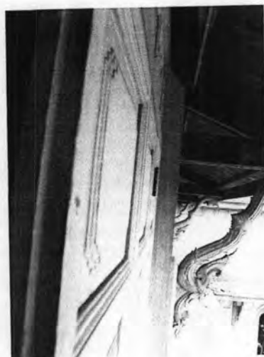
ภาพที่ 3.2-16 ลักษณะของโครงสร้างผนังลูกฟักของหน้าต่างชั้น 2
