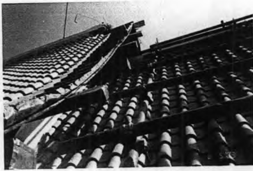
ภาพที่ 3.1-18 ภาพขยายส่วนโครงสร้างด้านหน้าก่อนติดตั้งเครื่องลำยอง แสดงถึงลักษณะการมุงกระเบื้องทับกด้วยลบบนระแนงซึ่งวางบนแผ่นสังกะสี
