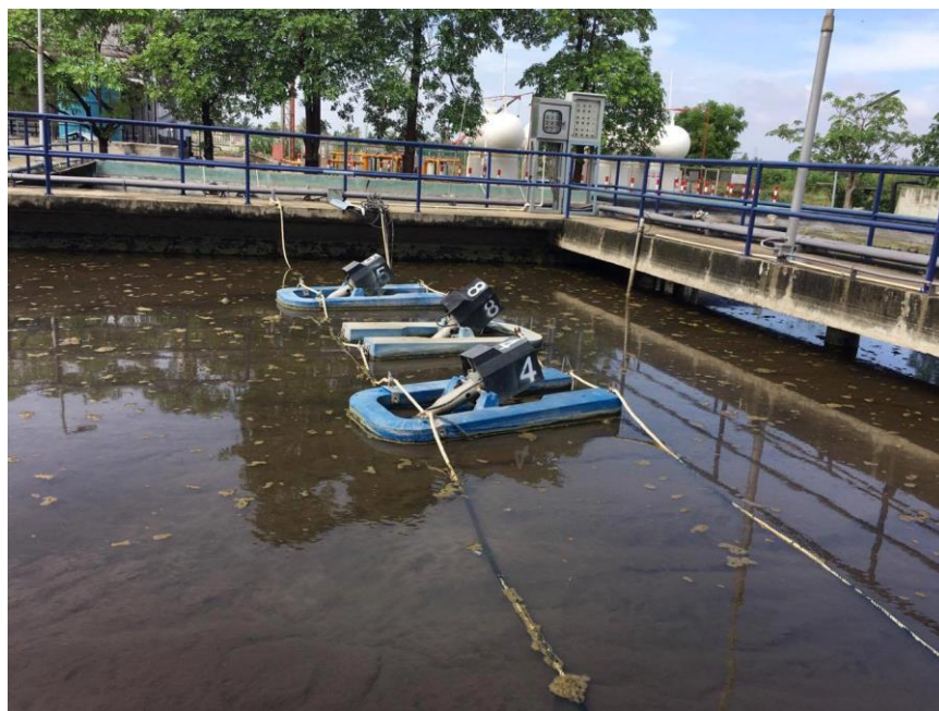
ภาพที่ ก ระบบบำบัดน้ำเสียแบบเอสปีอาร์ ของบริษัททีปโก้ เอฟ แอนด์ บี จำกัด
