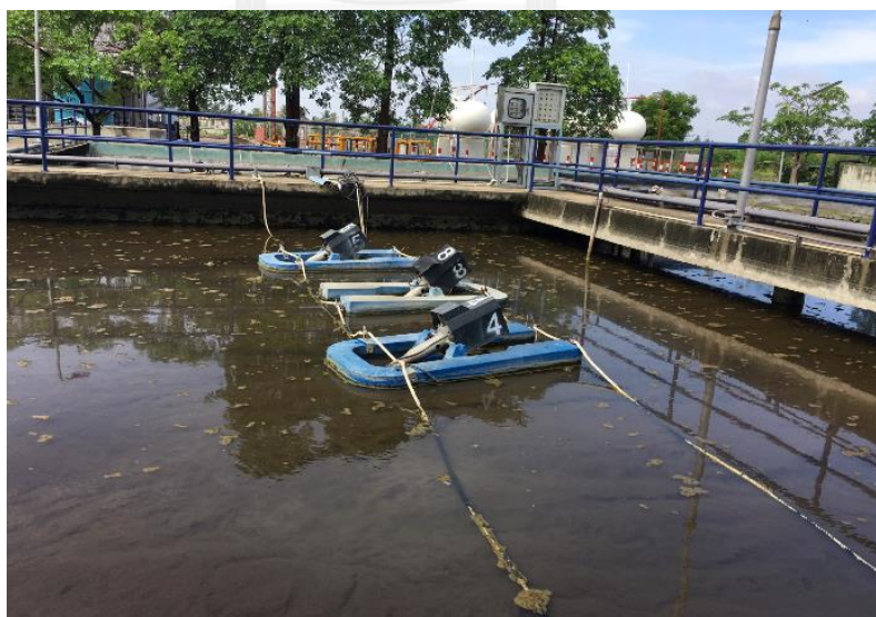
ภาพที่ 18 ระบบบำบัดน้ำเสียแบบเอสปีอาร์ ของ บริษัททิปโก้ เอฟ แอนด์ บี
