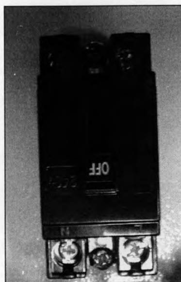
รูป 4.2 แสดงการติดตั้ง Breaker กลับทิศทาง
